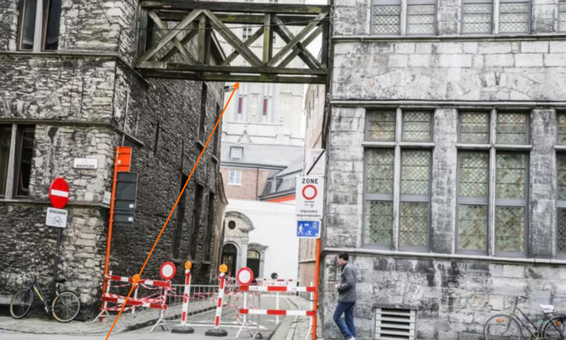
Foto boven - Begin april 2018. Enkele brokstukken v/d houten constructie om de muur te schoren tussen de Kleine Sikkels links en het conservatorium rechts komen naar beneden. De straat werd tijdelijk (7dagen) afgesloten tot het euvel werd verholpen.
